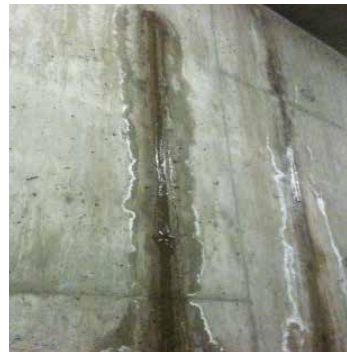
Filtración en juntas
