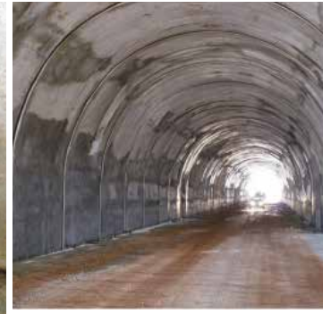
Filtración al interior de túneles
