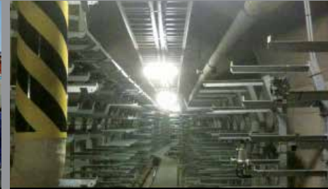
Túneles de Suministro de Energía, Praga, Rep. Checa
