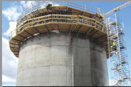
Planta de Biogas Tartu, Estonia
